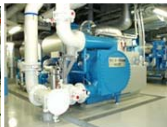
ターボ冷凍機(1,800RT)
