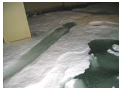
マルチ蓄熱槽に浮かぶ シャーベット上の白い氷
