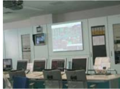
中央監視室:中央監視設備
