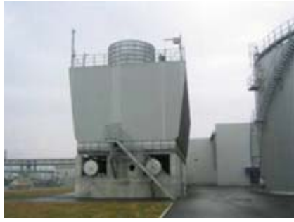
冷却塔(2,400RT×5基)
