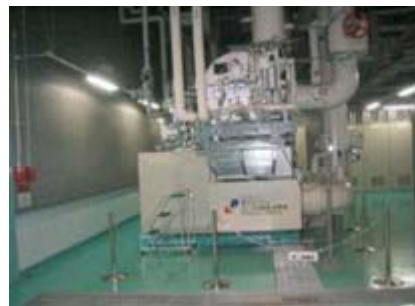
蒸気タービン駆動ターボ冷凍機+発電機 (630RT+250kW)
