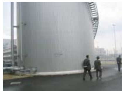
冷・温水蓄熱槽(900m 3 )
