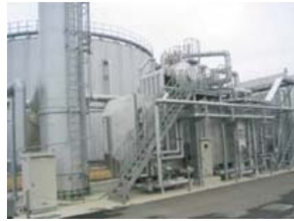
ガスタービンコージェネレーション (電力:4,740kW、蒸気:10.46ton/h)
