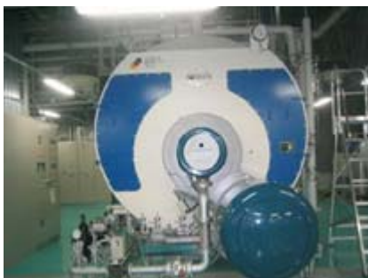
蒸気ボイラ(15トン/h)
