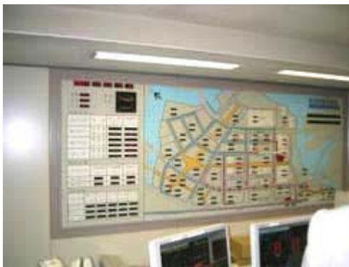
中央監視室: 地域導管グラフィックパネル
