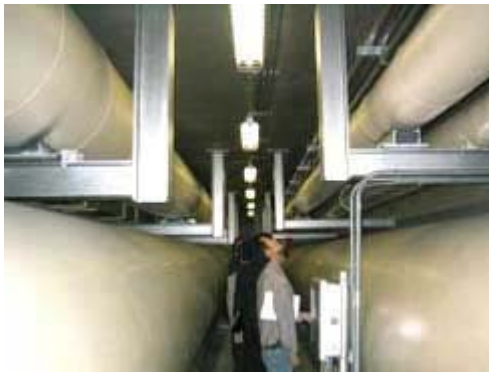
センタープラント センタープラント 地域導管用共同溝
