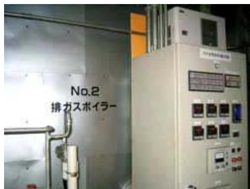
コージェネレーション用排ガスボイラ
