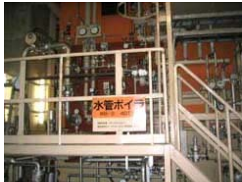
センタープラント 水管ボイラ: 換算蒸発量 40TON/h
