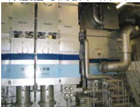
第2プラント 吸収冷凍機: 冷凍能力 5,000RT
