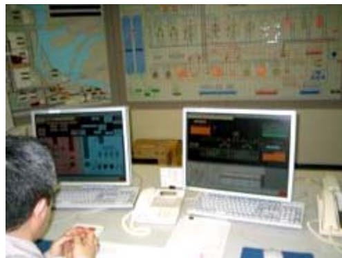
中央監視室: 中央監視盤
