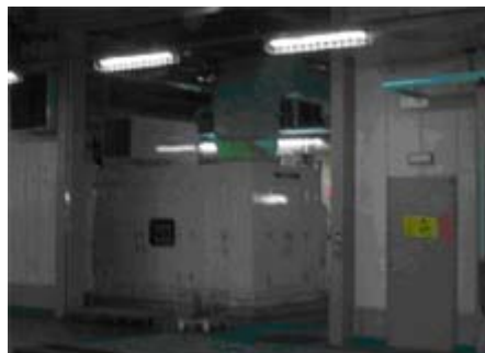
ガスタービン発電装置 (電力:2,000kW、蒸気:6 ton/h)
