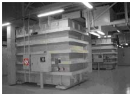
電気室内 トランス
