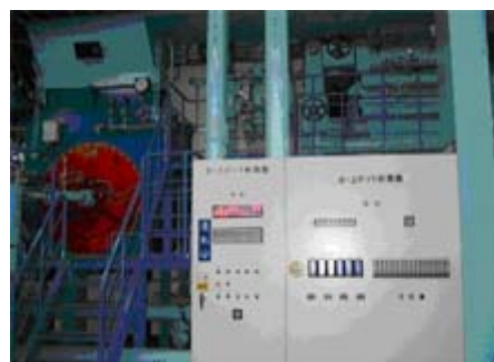
水管式蒸気ボイラ(45トン/h)
