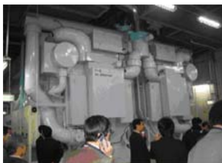
世界最大級蒸気吸収冷凍機(5,000RT)
