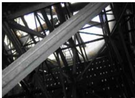
冷却塔内部より (重層式冷却塔、白煙防止装置付)
