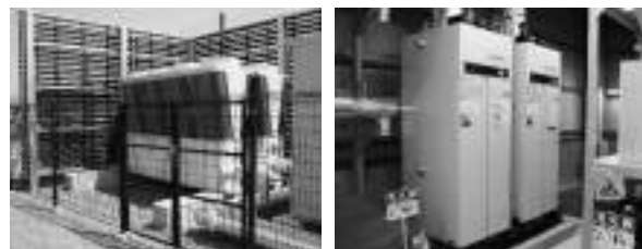
図10 空冷チラー&ガスボイラー
