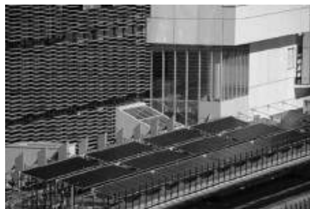
図9 太陽熱集熱器（歩行者デッキ屋根面）
