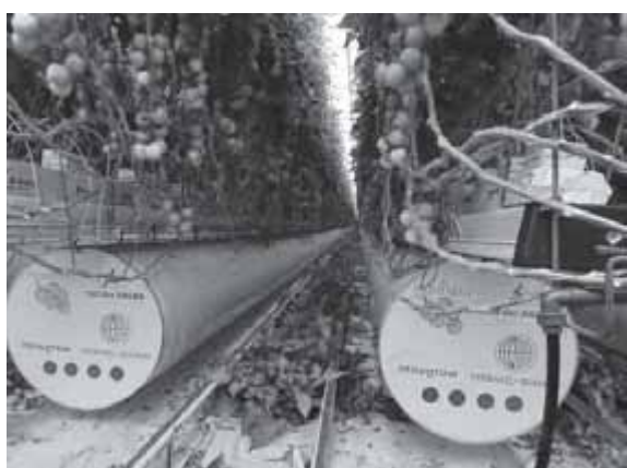
写真6 房状トマト栽培と冷温風ダクト
