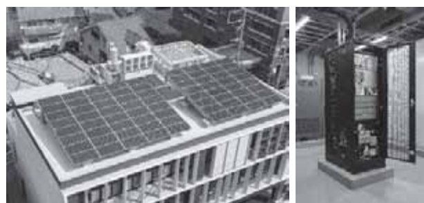
図4 太陽光発電パネルと直流給電システム
