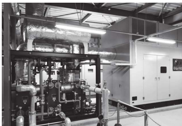
写真3 トリジェネレーションシステム
