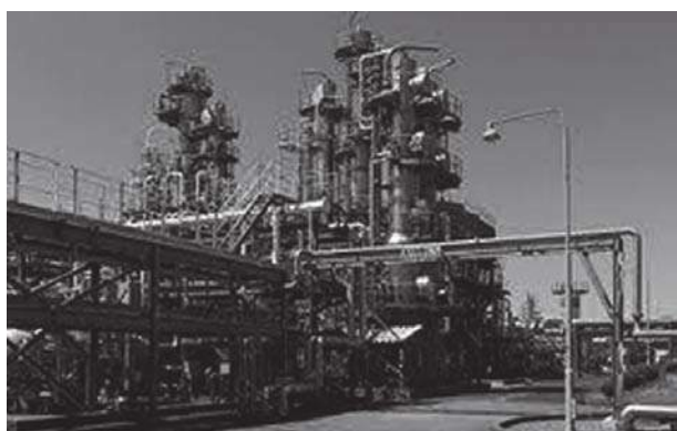
写真3 国際石油開発帝石(株)越路原プラント
