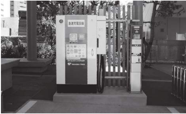
図20 豊洲シビックセンター1階の充電設備
