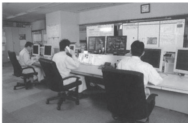
図-6 コントロールルーム
