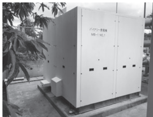
写真5 バイナリー発電機
