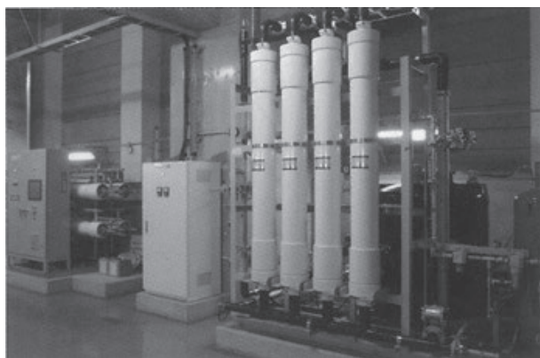
図-8 冷却水ブロー水リサイクル装置
