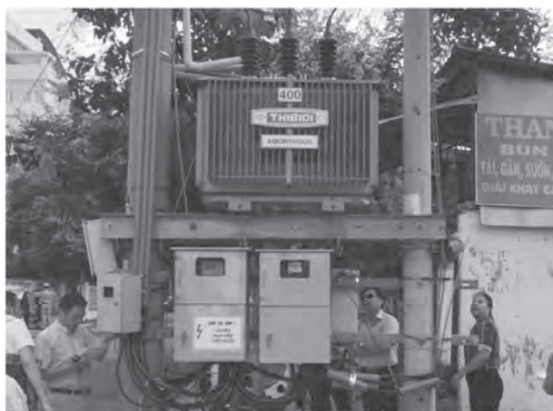
写真 ベトナム国で導入されているアモルファス変圧器
