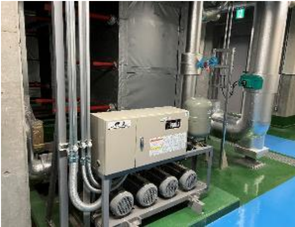
森JPタワーへの送水ポンプ
