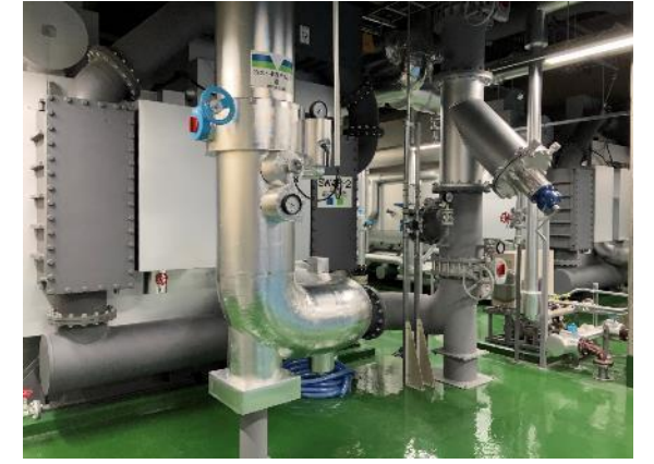
排熱回収型吸収冷凍機
