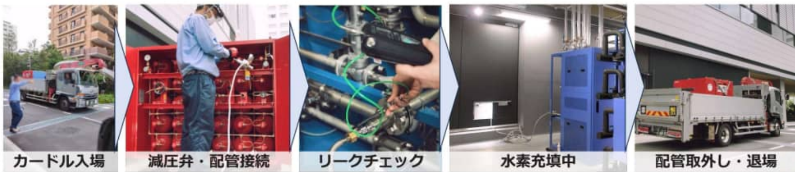
オフサイトからの水素供給実証
